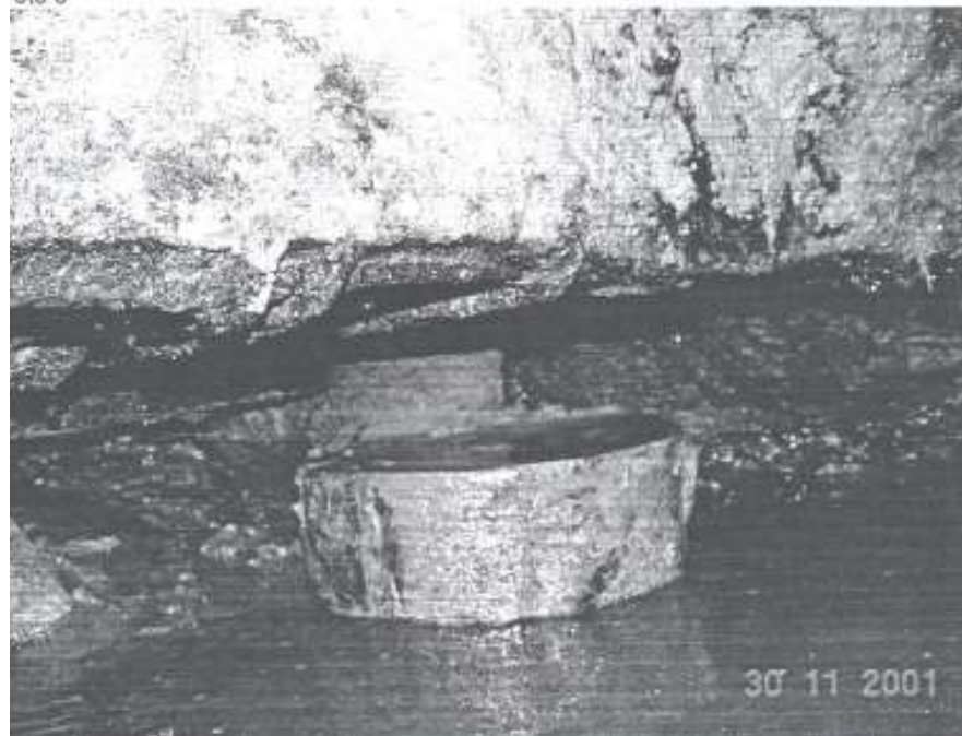
Figuur 30 Bron foto funderingsonderzoek Fugro in Dordrecht De funderingspaal is van onder de betonbalk weggetrokken door optredende negatieve kleef. Oorspronkelijk stak de paal minstens 3 cm in de betonbalk (instorting)
