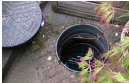
Infiltratieput in achtertuin Krommedijk te Dordrecht
