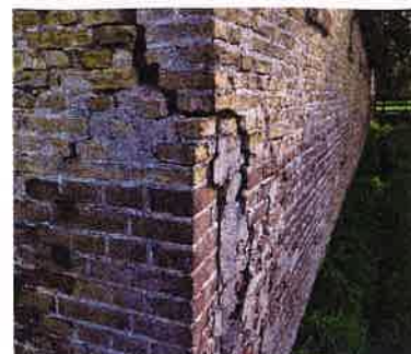
Funderingsproblemen beginnen met scheuren in de muren.
