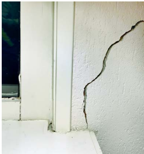
Figuur 5 – Scheur in muur en kozijn aan de binnenkant van de probleenhoek.
