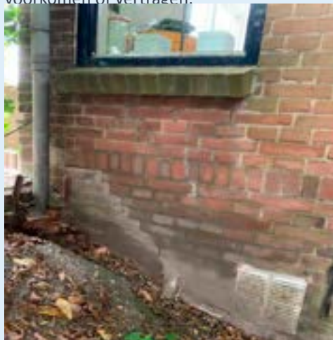
Figuur 5: Zichtbare funderingsschade buiten
