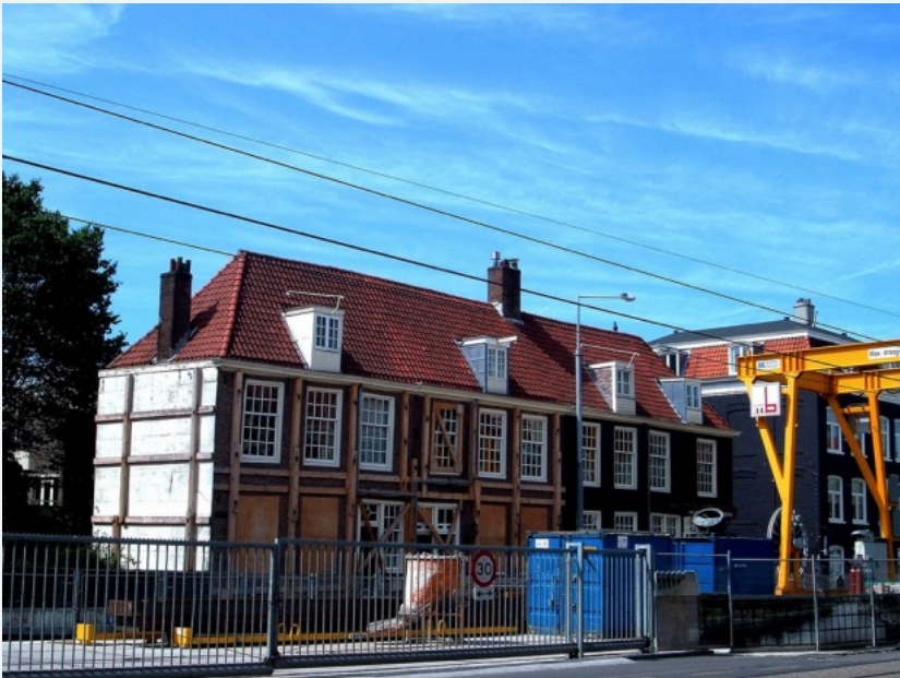
Verzakt gebouw Amsterdam Vijzelgracht
