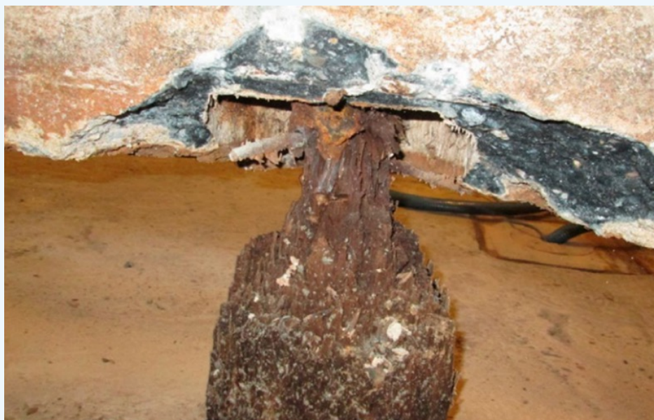
Figuur 4 en 5 Paalrot bij houten funderingspalen en scheefstand fundering op staal
